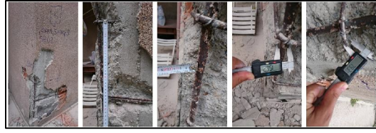
L Şeklinde Siyırma Etriye Aralığı Pas Payı Boyuna Donatı Çapı Enine Donatı Çapı
